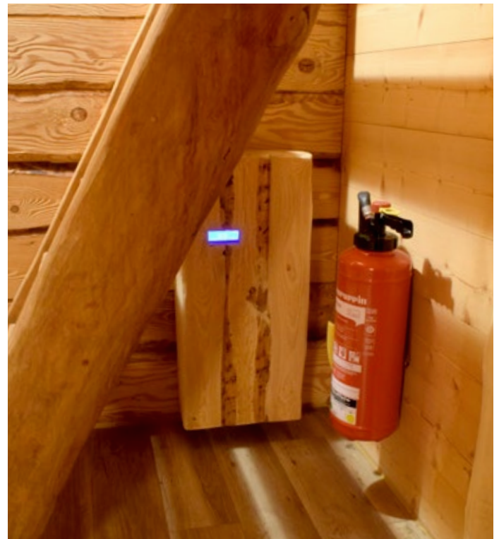
Dezent integriertes Notlichtsystem CLS 24 Subtly incorporated CLS 24 emergency lighting system
