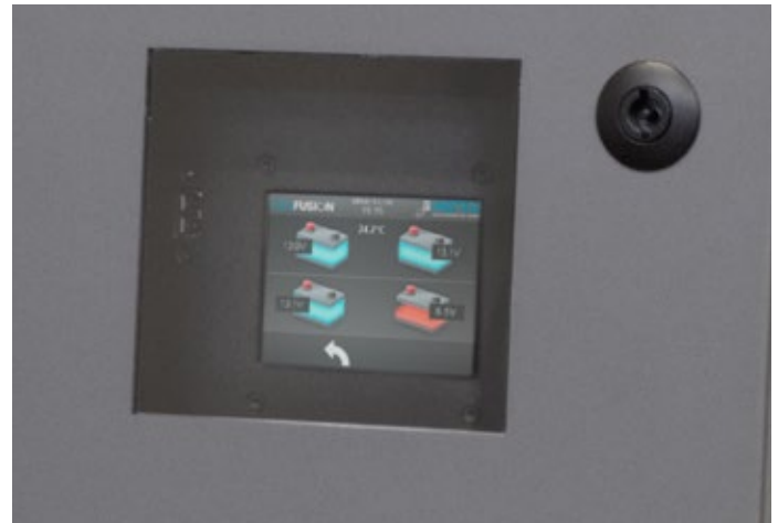
Bild 9: Fehlermeldung einer Batterie an einer CLS FUSION
